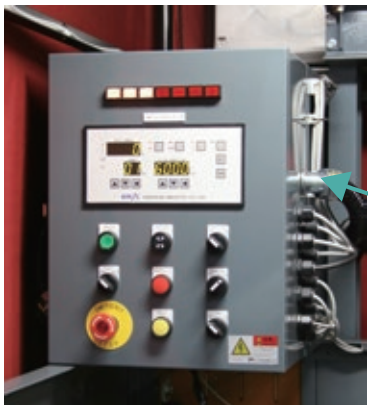
定電流ユニット組込み型操作盤
